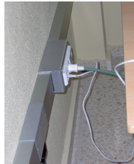
Conexiones a la regleta
