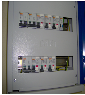
Instrumentos del cuadro eléctrico
