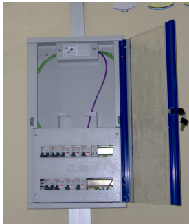
Cuadro eléctrico del aula
