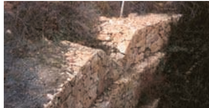
Este muro de contención ha conseguido parar la cárcava y ahora sirve para controlar el desagüe
