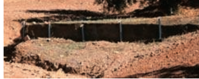
Este muro de contención ha empeorado la cárcava en vez de pararla, porque no llega bien a los dos lados de la cárcava y el agua ha encontrado como pasar por un lado de la estructura
