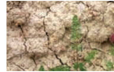
Grandes áreas compactadas o con costra superficial
