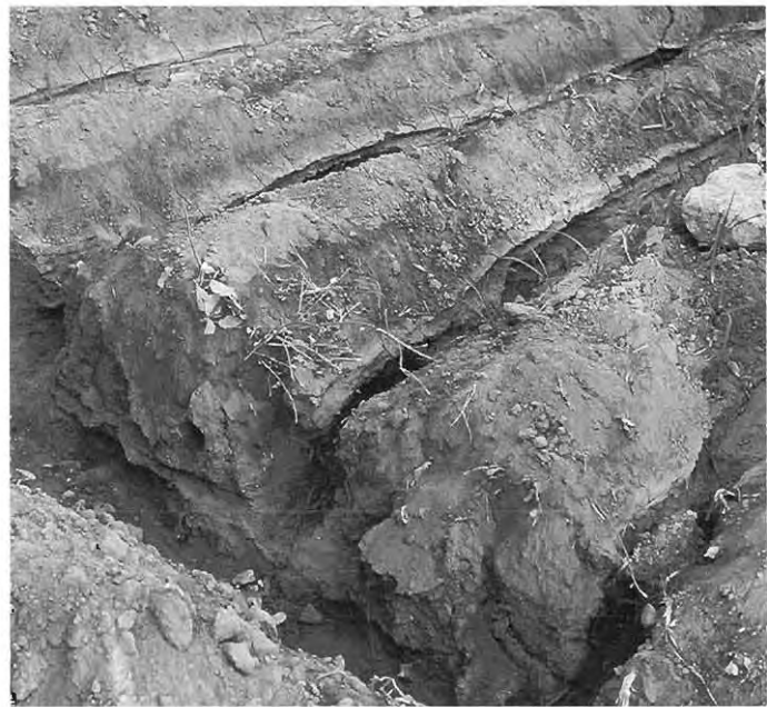
Figura 7. Deterioro de los canales de desagüe en un sistema de riego por surcos.
