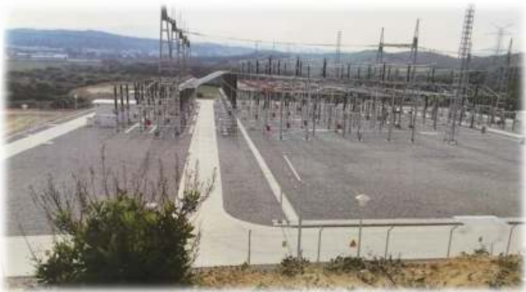
Subestación eléctrica El Cañuelo (Algeciras).
