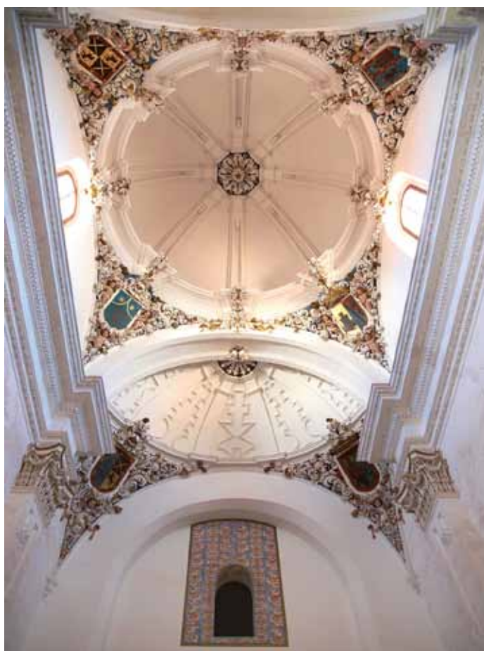
Yaserías de la bóveda de la iglesia de Santa Clara. Antequera (Málaga)
