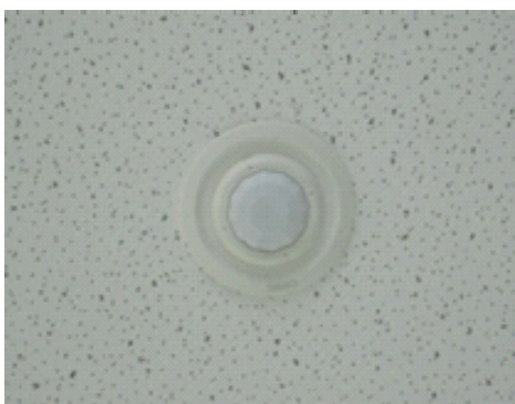
Figura 19: Detector de presencia que controla el encendido de las luminarias.
