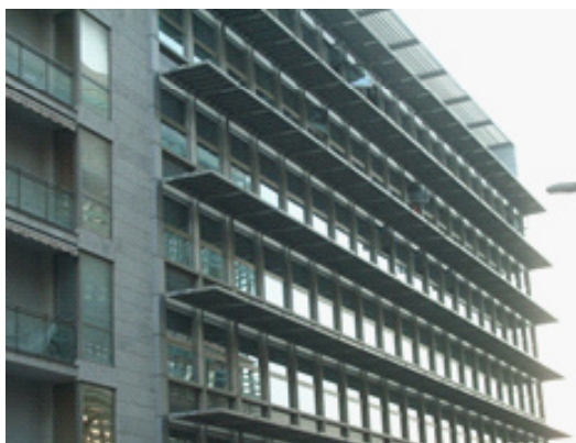
Figura 101: Módulos fotovoltaicos utilizados como voladizo para la protección solar en el Hotel Monte Málaga.
