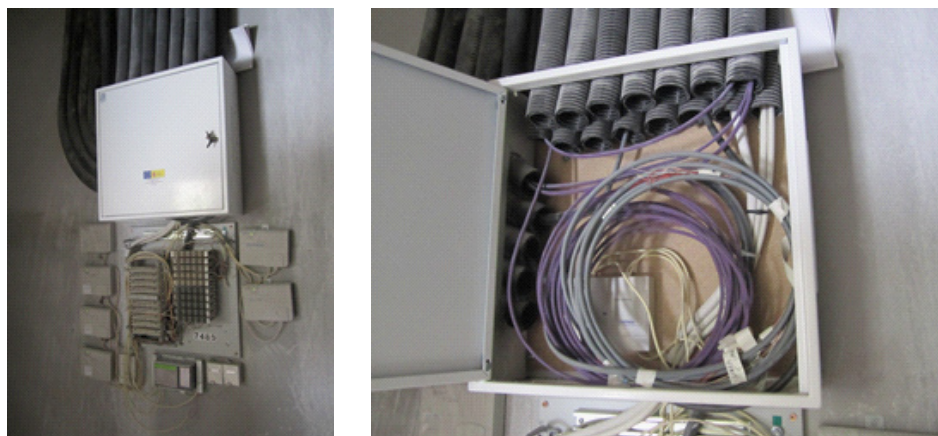
Figura 49: Recinto instalaciones de telecomunicaciones inferior, RITI.
