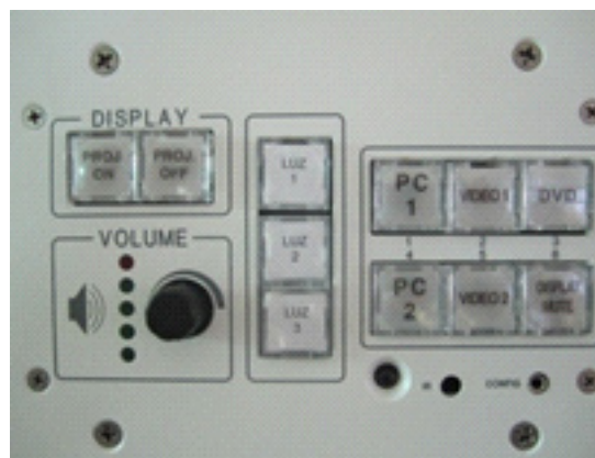
Figura 43: Control centralizado de una sala multimedia.
