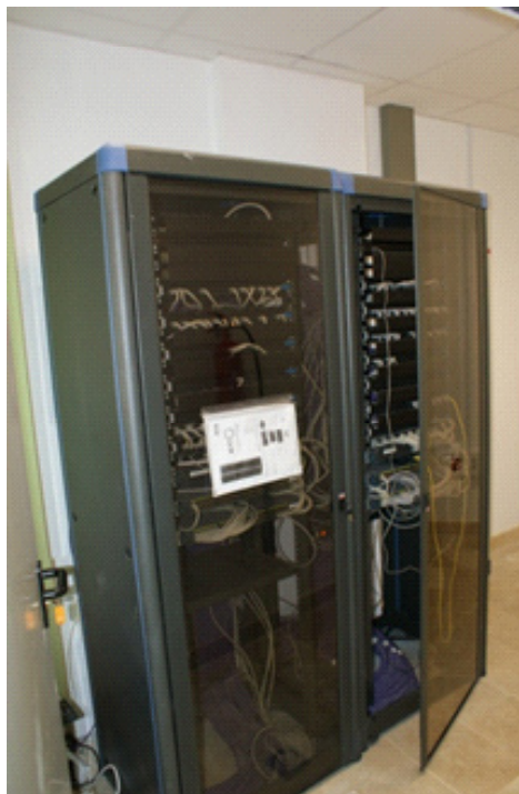
Figura 45: Racks de telecomunicaciones.
