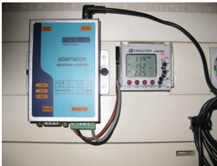
Figura 73: Analizador de potencia y adaptador a red.
