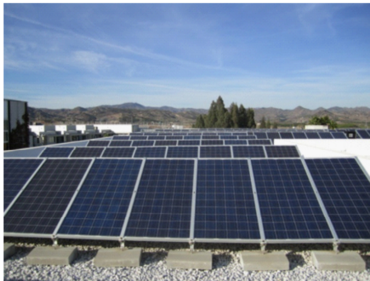
Figura 21: Paneles fotovoltaicos interconectados a la red eléctrica.
