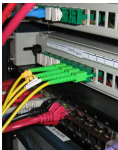
Figura 86: Conexiones fibra óptica a panel.
