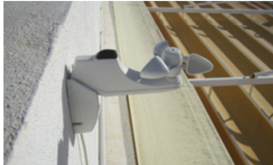
Figura 17: Sensor de luminosidad y anemómetro que controlan el movimiento de un toldo.
