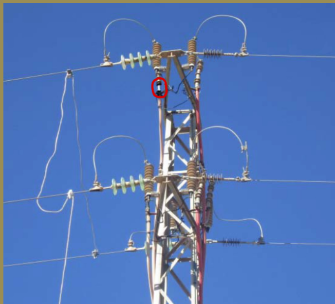
En rojo se señala la botella terminal averiada. El lado izquierdo estaba puesto a tierra y en cortocircuito. El derecho en tensión.
