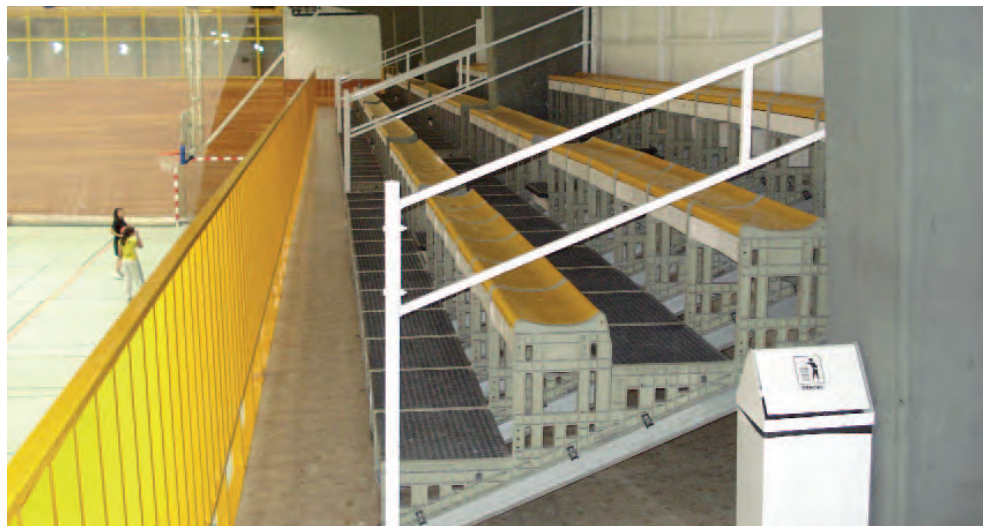
Barandillas de protección.
