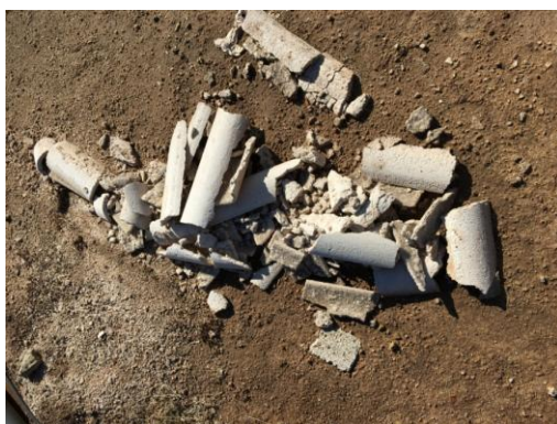
Vista de las incrustaciones que se producen en las tuberías de conexión
