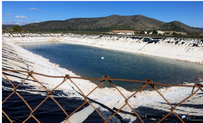
Vista de la balsa nº 3 o de almacenamiento de salmuera
