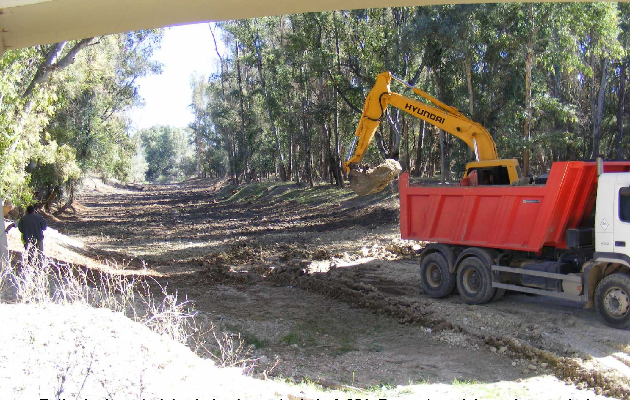
Retirada de materiales bajo el puente de la A-381. Reapertura del canal secundario
