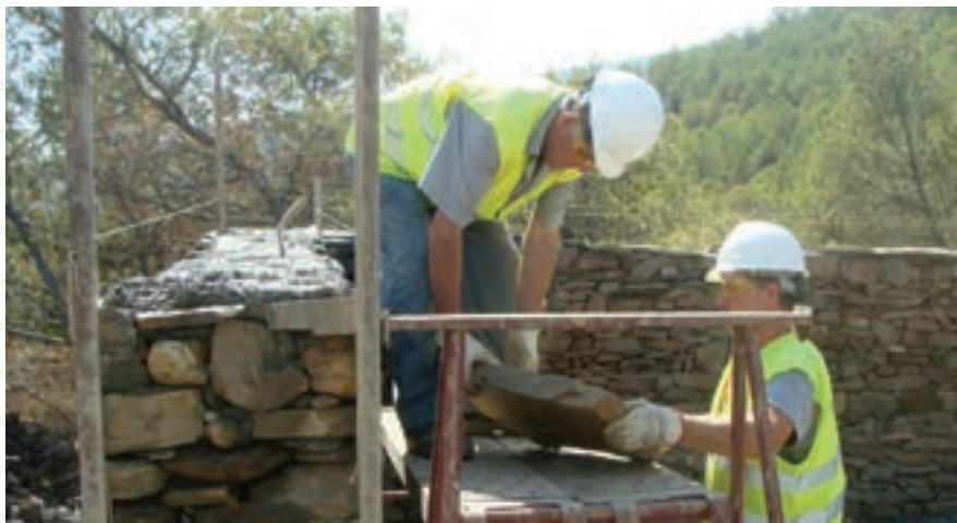
Ejecución de obras de restauración, mejora y puesta en valor de infraestructuras ganaderas en la provincia de Almería
