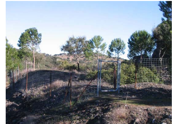
Cercado perimetral instalado en el socavón principal de la mina Palanco I y IV.
