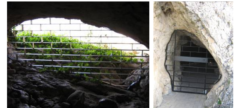
Rejas instaladas en las entradas de la cueva de las Ventanas incompatibles con los murciélagos.
