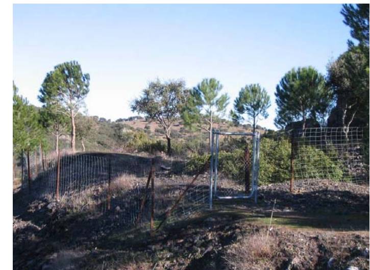
Cercado perimetral instalado en el socavón principal de la mina Palanco I y IV.
