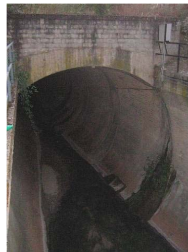
Túnel del Trasvase del Cubillas
