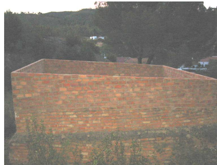
Pozo de Sotiel Coronada II rehabilitado con muro de ladrillos para evitar accidentes
