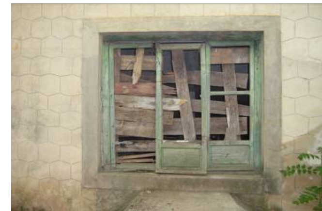
Ventana del edificio tapada provisionalmente para evitar vandalismo en el interior.
