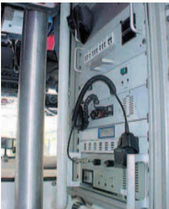
EMISORA DE LA UMMT. AL LADO, EQUIPOS MÓVILES Y PORTÁTILES DE COMUNICACIÓN.
