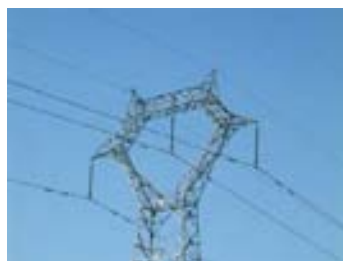
Torre de alta tensión sobre núcleo urbano
