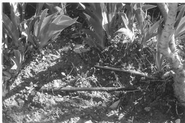
Figura 3. El crecimiento de las raíces sobre las tuberías de riego subterráneo puede dar lugar al estrangulamiento de las mismas.
