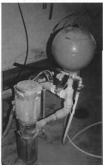
Figura 9. Equipo de bombeo con calderín.
