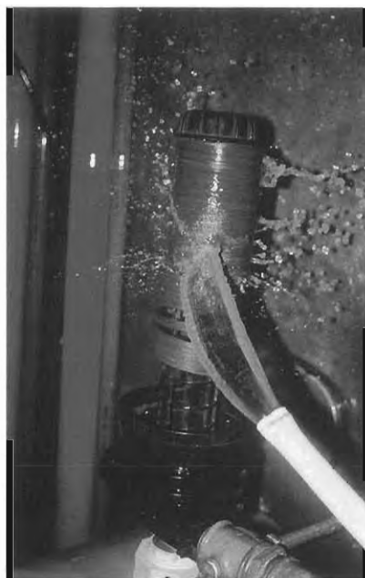
Figura 8. Limpieza manual de un filtro de anillas.
