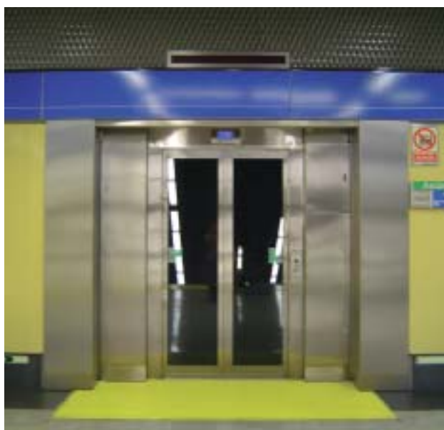
Ejemplo de señalización de ascensor con pavimento de textura y color diferenciado
