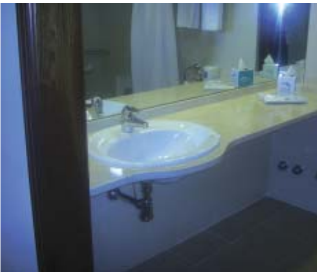
Ejemplo de lavabo y encimera que permiten la aproximación frontal de una persona en silla de ruedas. La grifería situada en la parte inferior del lavabo debería ser un tubo flexible, con aislamiento térmico
