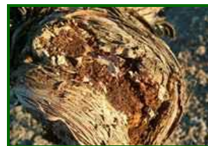
Daños por termitas
