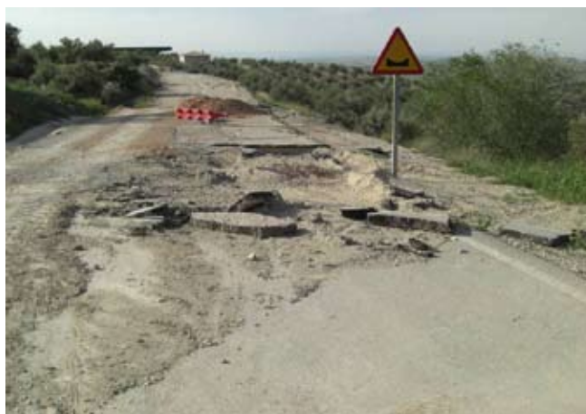
Desperfectos sobre JA-3200 producidos por desprendimientos
