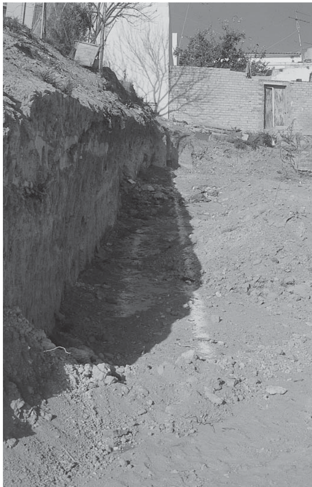
LÁM. VII. Seguimiento de las obras de acceso al parque público del Cerro Mariana.
