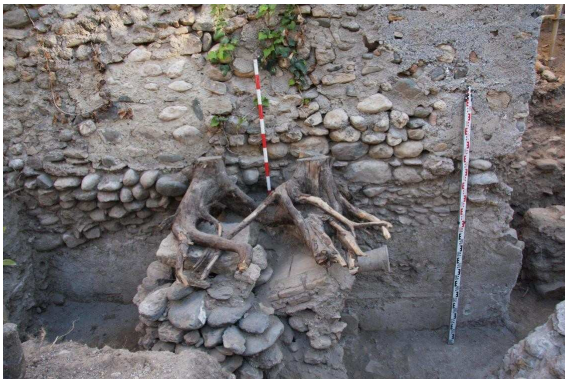
Fig 30 - Frontal del torreón en el que se observa el enfoscado localizado soterrado. En primer plano la UE26.
