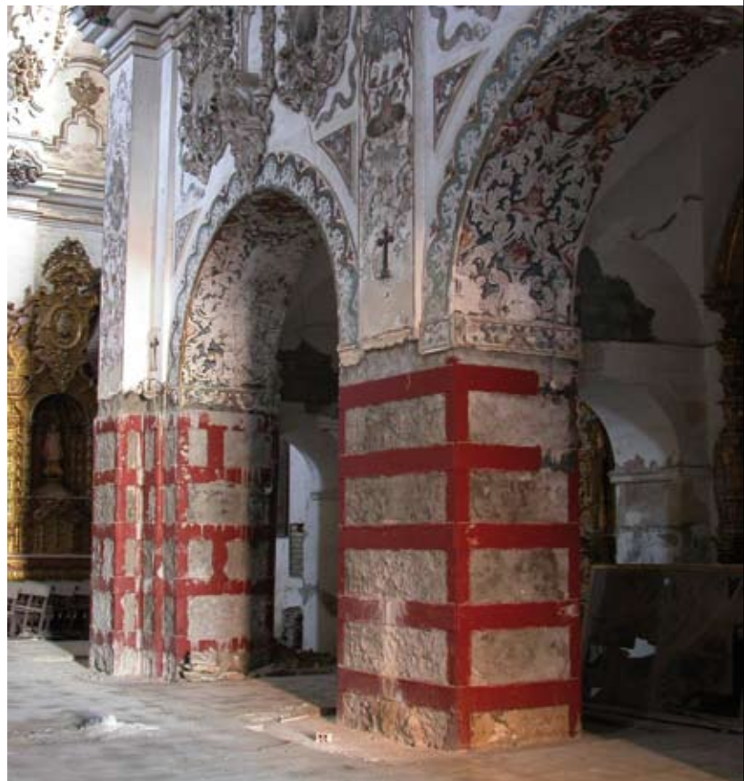
Estado del interior del templo antes de la intervención.
