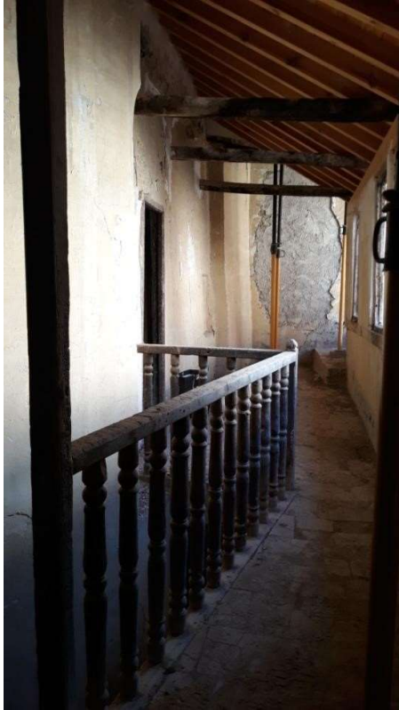
F.07 Baranda y pasamanos de escaleras de acceso a planta superior desde el patio principal.
