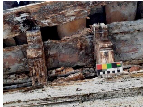
F.06 Canes lobulados que culminan a las jaldetas con anteriores, que soportan el voladizo de la cubierta de la su galería 04 elementos decorativos
