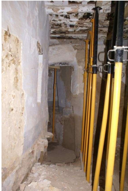
F.01 Acceso desde habitación 03 a habitación 01, al sur. En lateral, cabezas de vigas del forjado entre plantas.
