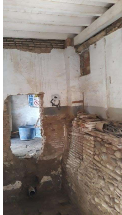
F.19 Esquina sureste de sala 01 donde se aprecia el suelo de la planta baja y la línea de forjado entre la planta baja y primera.
