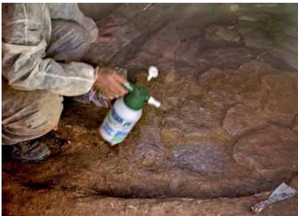
Lámina 10.7. Aplicación de primal para consolidar la superficie de contacto con la silicona.
