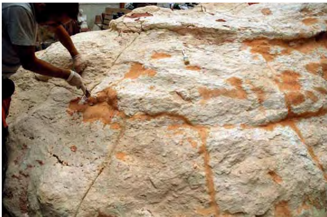
Lámina 10.72. Recubrimiento con mortero de las uniones entre piezas y las lagunas que hemos aislado con el desmoldeante.
