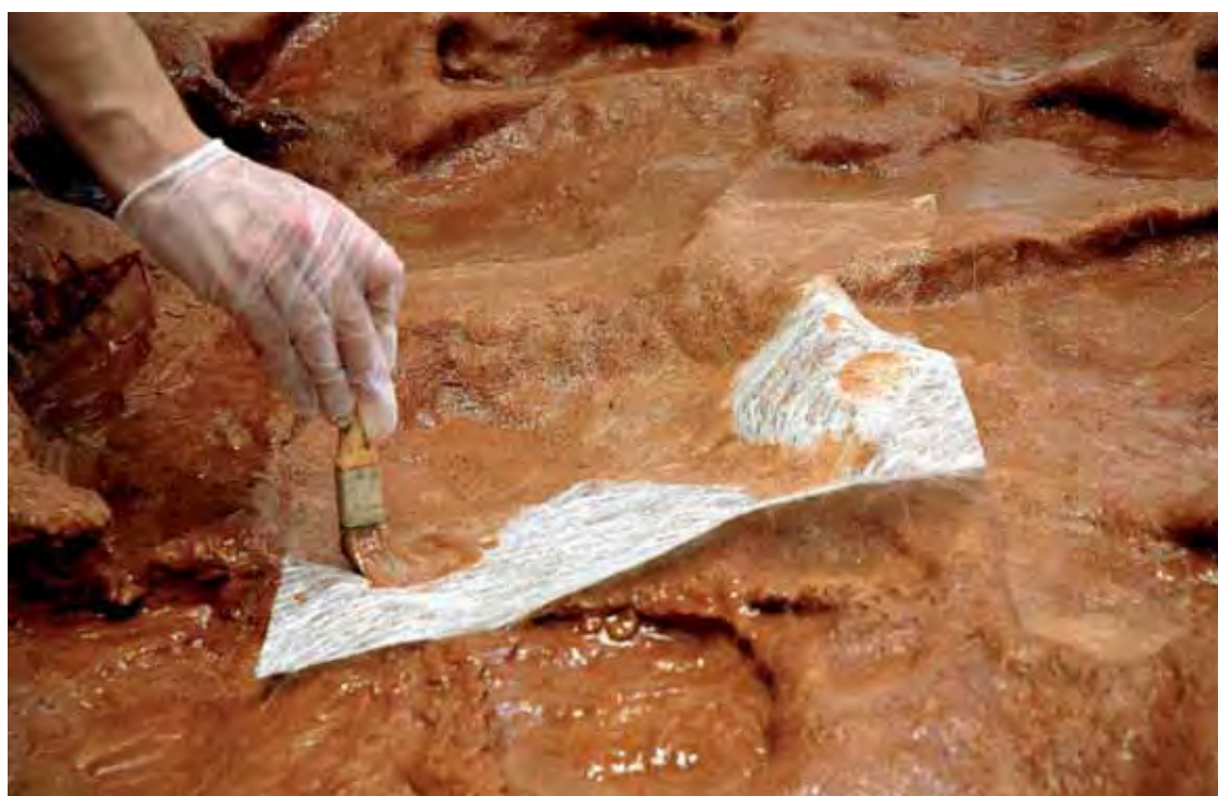
Lámina 10.67. Saturación de la fibra de vidrio con resina en la tercera capa.
