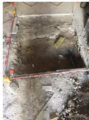
Restos de la capa de cemento y de red de abastecimiento de cobre
