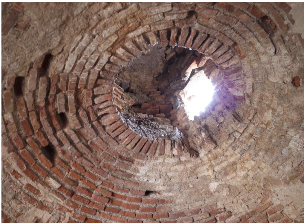
Figura 11: Remate de óculo en la bóveda de ladrillo y rotura para apoyo de escalera de subida a la terraza.
