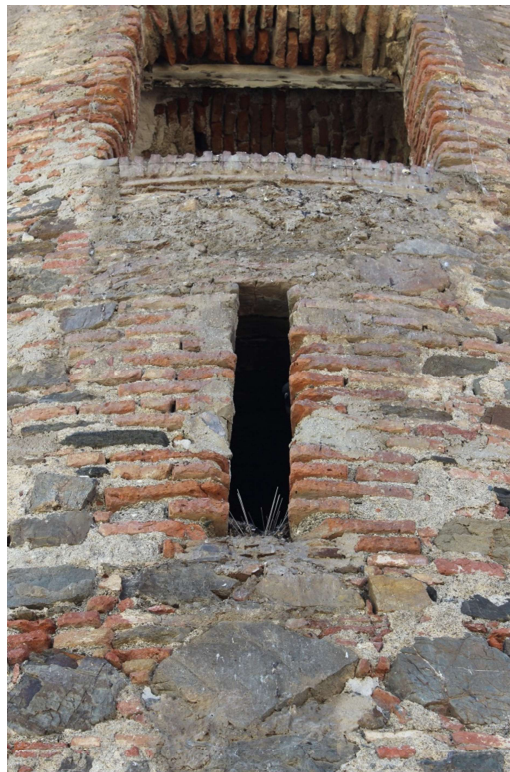
Figura 8: Detalle de una de las aspilleras y de la puerta de entrada con reparaciones en el umbral.
