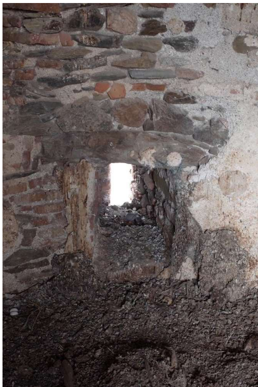
Figura 9: Abertura interior de una de las aspilleras a nivel del relleno de detritos y excrementos de paloma.
