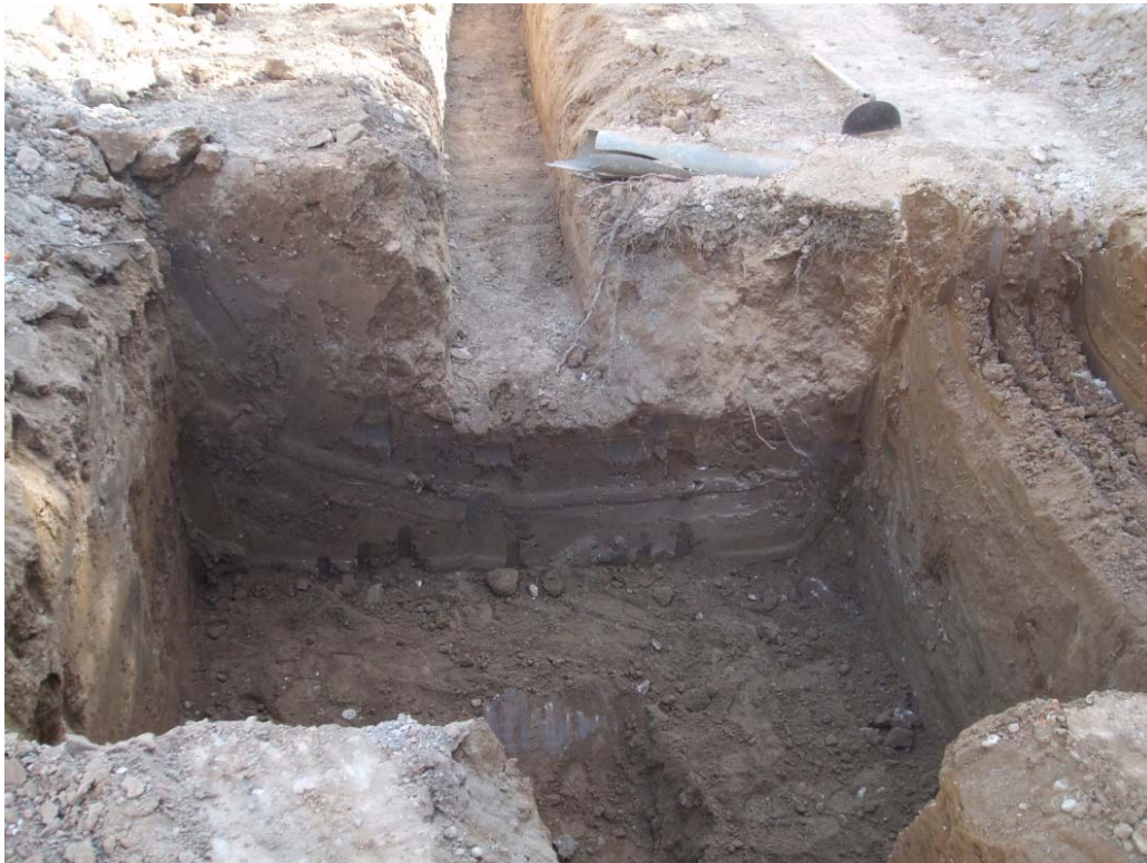
Arqueta en calle Francisco Pradilla.
