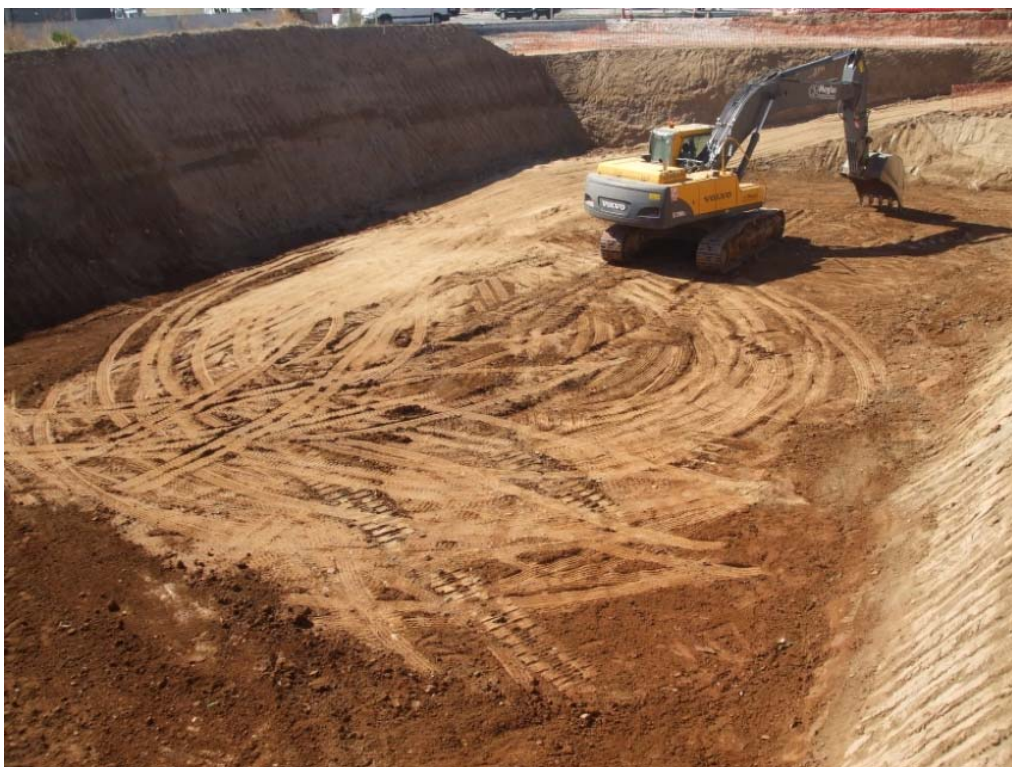
Rotonda de la Calle Luis Amador. Subestación eléctrica.
