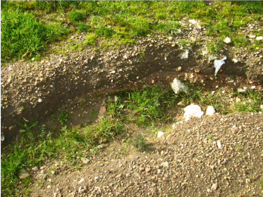
Fotografía 5: perfil creado por las lluvias en el que se aprecia el sedimento aportado sobre la terra rossa natural de la zona.
