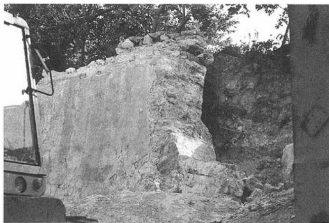
LAM. I. Murallas de Tapiál destruidas de la C/ Horno Puerta Granada.
