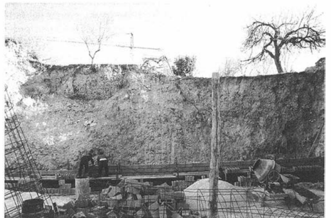
LAM. IV. Perfil arqueológico dejado por la destrucción de la muralla y zona donde se emplazaba el lienzo.
