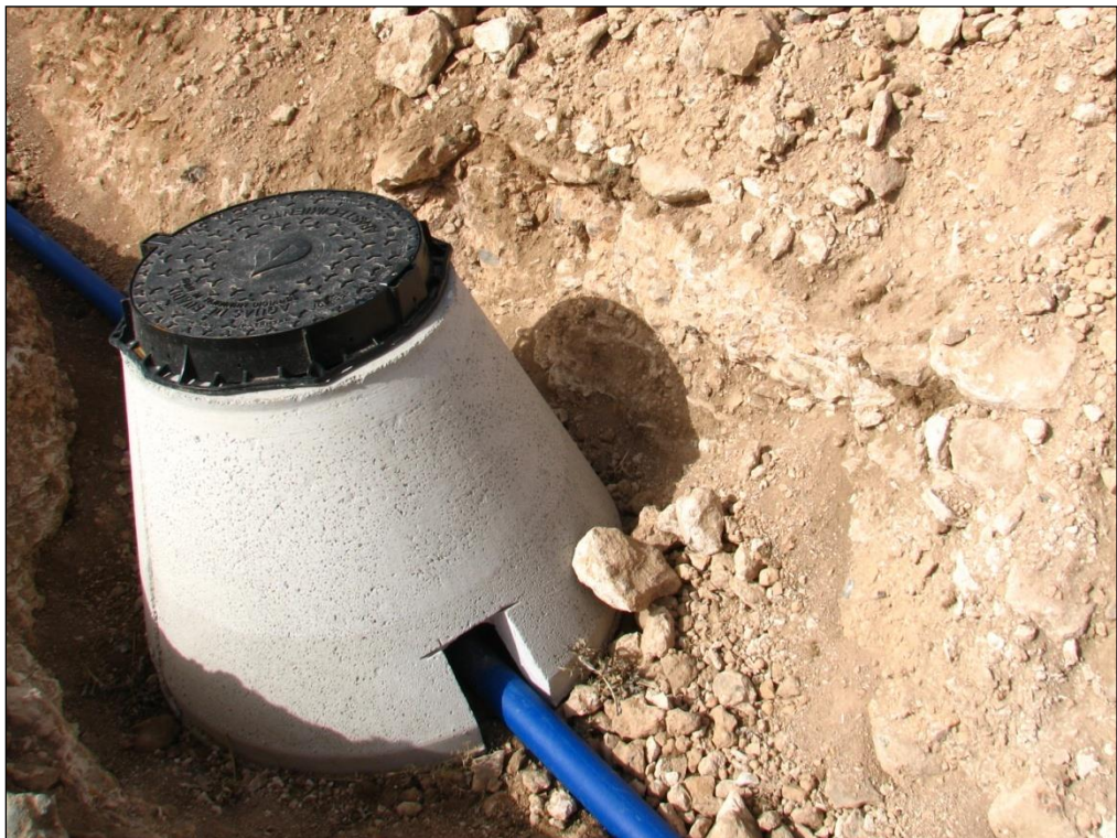
Figura 6: registro de la conducción sin cubrir.
