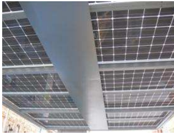
Figura 56. Instalación de carga de vehículos eléctricos (arriba) y detalle de paneles fotovoltaicos en la Marquesina (abajo) [56]
