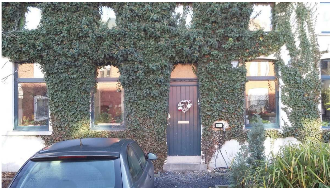
Figura 29. Instalación WALLBOX en vivienda [39]
