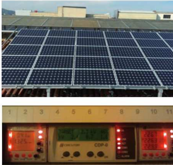
Figura 50. Vista parcial del campo solar y detalle del modulador de potencia CDPO que realiza el control con inyección cero [57]
