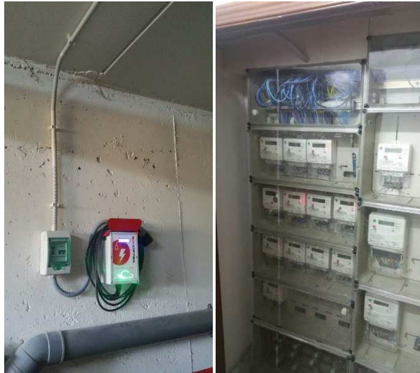
Figura 41. Punto de recarga y cuarto de contadores [55]
