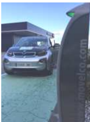
Figura 54. Punto de carga ING CITY instalado en una gasolinera [35]
