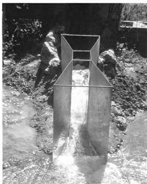
Figura 15. Aforador Parshall instalado para medir el caudal a la entrada de un tablár.
