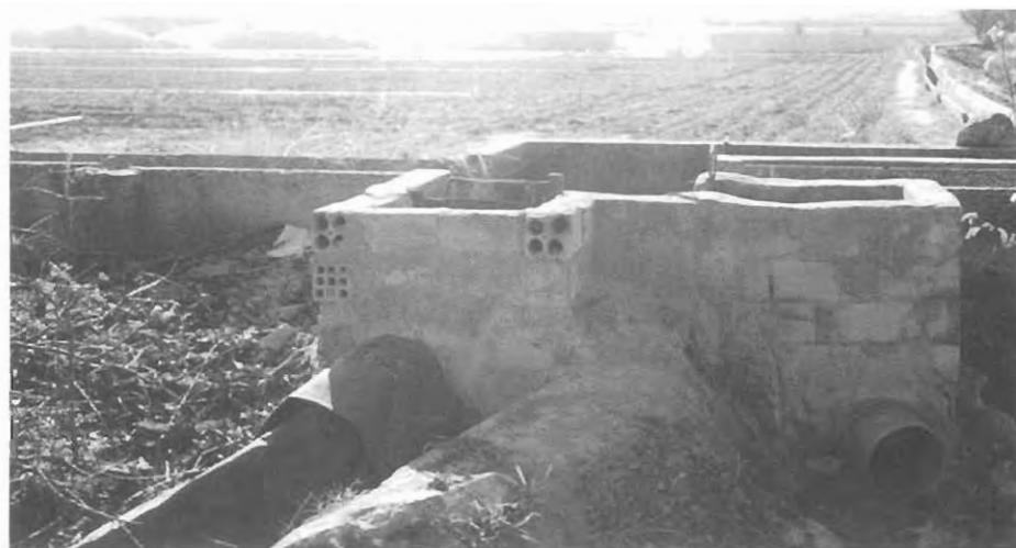
Figura 5. Arqueta de distribución dotada de varias salidas de agua a parcela.
