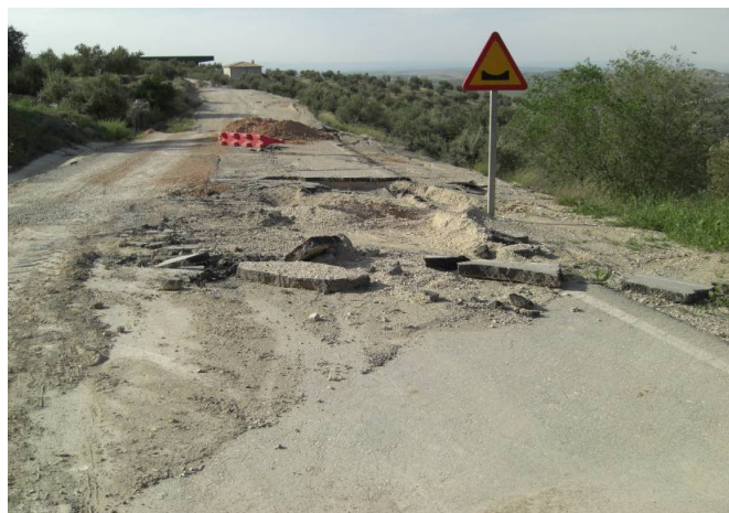
Desperfectos sobre IA-3200 producidos por desprendimientos
