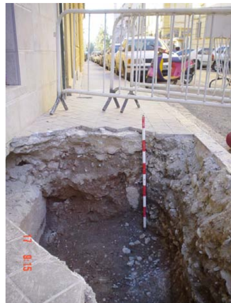
Lámina I. Bordillo acera anterior. Tramo 1
