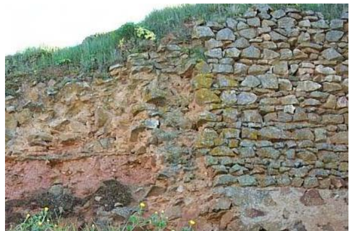
Lámina I. Detalle de las pérdidas de mampostería en el exterior del lienzo 5.
