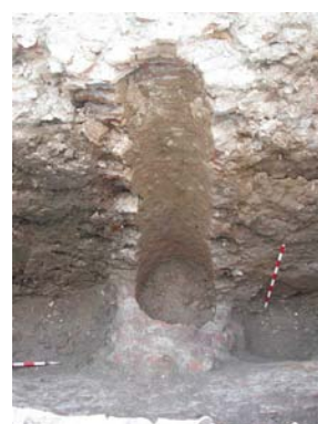
Foto 4. Alcantarilla o fosa séptica de gran potencia conectada directamente al colector
