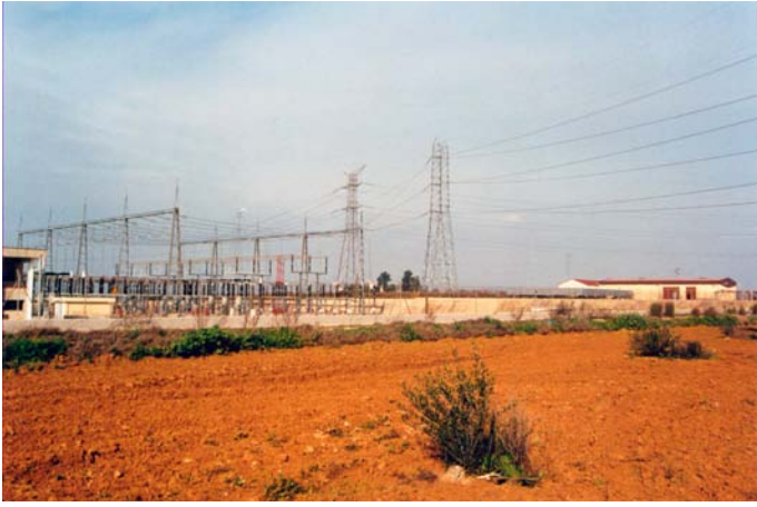
Lámina VII. Panorámica. Subestación eléctrica “Don Rodrigo”.
