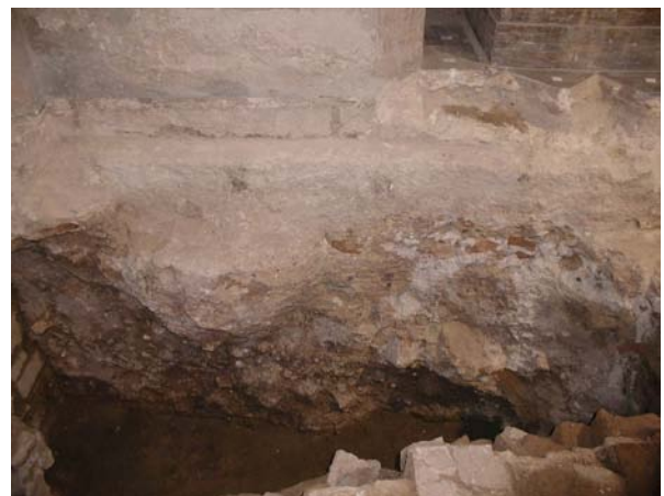
Lámina V. Detalle de la cimentación del muro occidental de la capilla realizado mediante vertido de mortero con ladrillo y cal en fosa perdida en contraposición al cimiento labrado que se observa en el borde izquierdo de la Lámina 1.
