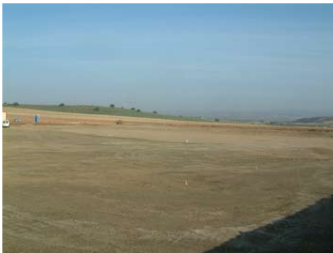
Lámina IV. Vista general de la subestación explanada.
