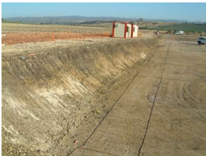
Lámina V. Vista general de taludes preparados y colocación de malla de cobre que se pone como toma de tierra.
