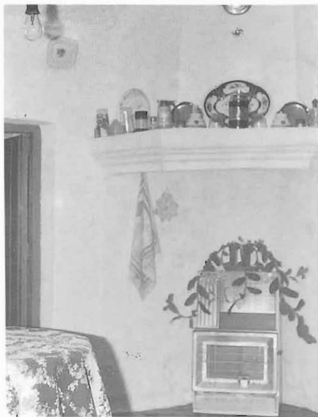
Graena. Cortes y Graena. Granada. La presencia de la estufa de gas butano bajo la campana de la chimenea indica la falta de uso de ésta.
