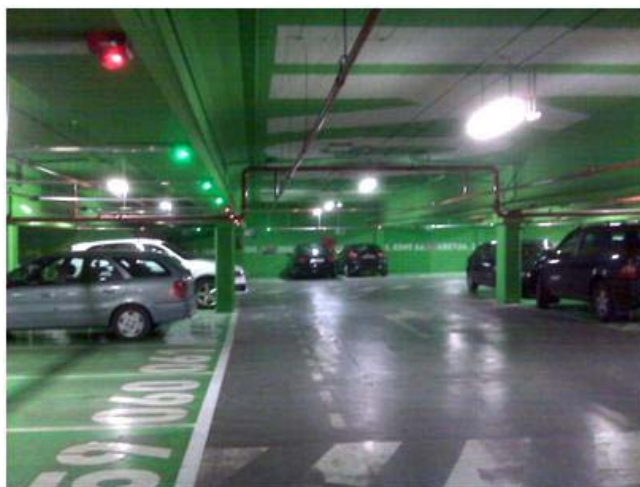
Gráfico 11.- Ejemplo de aparcamiento subterráneo dotado con sensores de presencia y testigos luminosos (verde y rojo) sobre las plazas para indicar la disponibilidad de las mismas.
