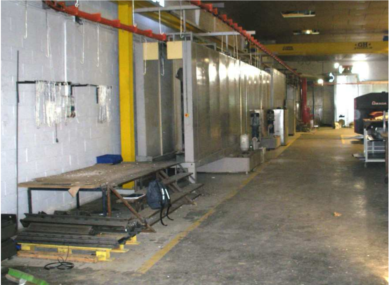
Imagen 1. Túnel de pintura de perfiles, con cuadro eléctrico ubicado al fondo de la imagen
