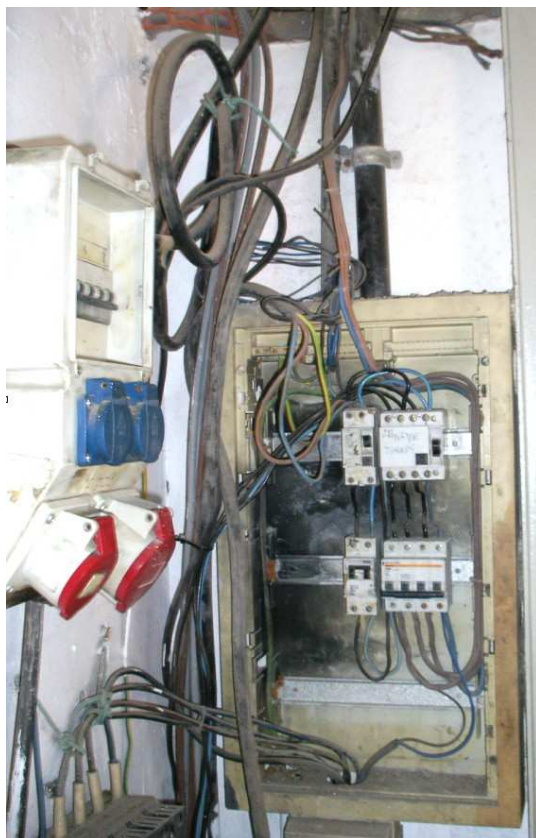
Imagen 5. En rojo se observa el conector desde el que se alimentó el cuadro eléctrico del túnel de pintura. La instalación eléctrica presentaba señales de manipulación indebida y de falta de mantenimiento
