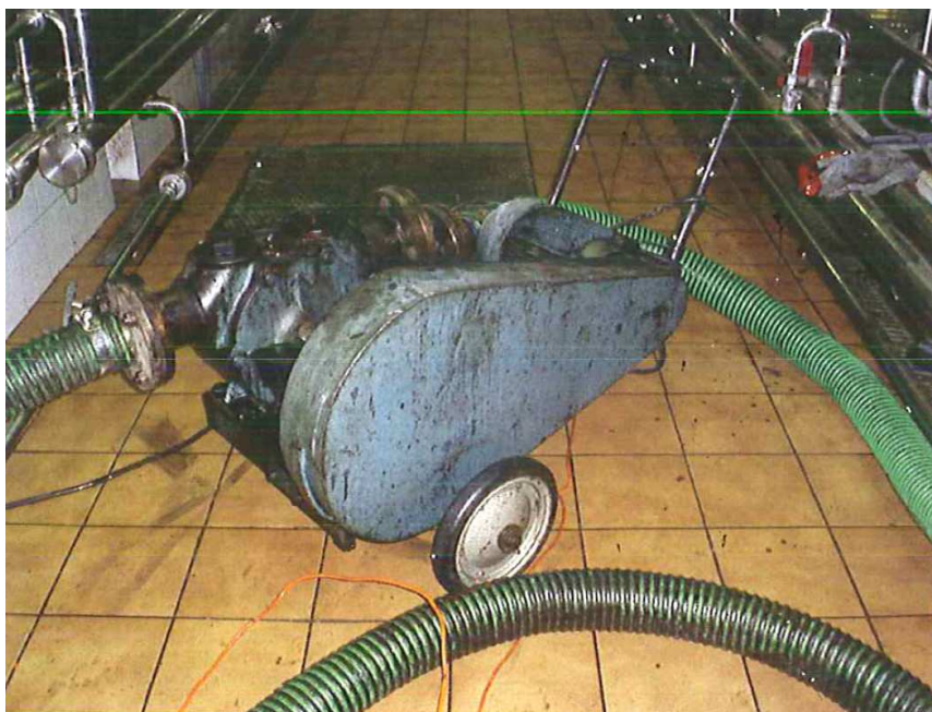
Imagen 2. Bomba de vaciado de turbios del interior del depósito.
