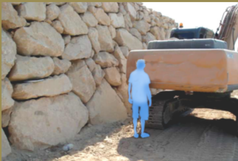
Zona en la que se produjo el atropello. Estando la máquina en paralelo al muro el operario or no percibió la presencia del trabajador.
