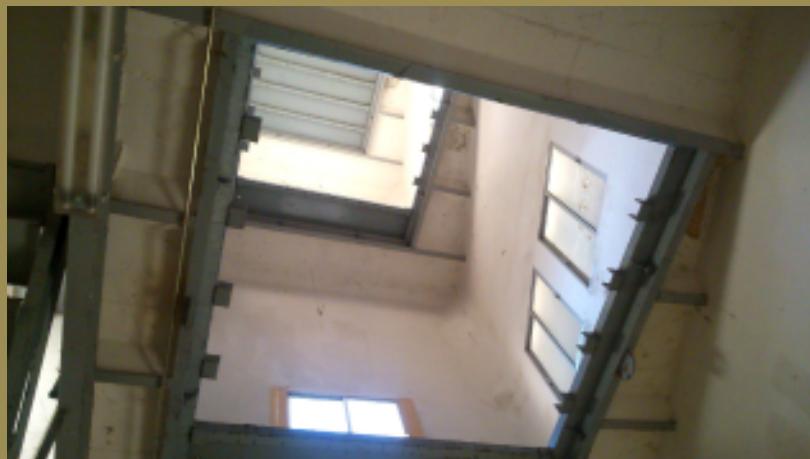
El trabajador cayó desde el hueco cubierto de la tercera planta
