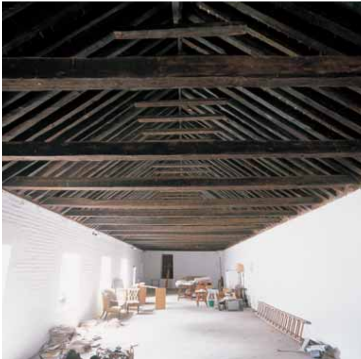
A la izquierda, en algunas cubiertas de las cámaras de planta alta puede contemplarse el magnífico trabajo en madera escuadrada, con estructuras de tipo par e hilera atirantadas. A la derecha, la nueva actividad presente en el Alitaje, la cría de caballos de pura raza.
