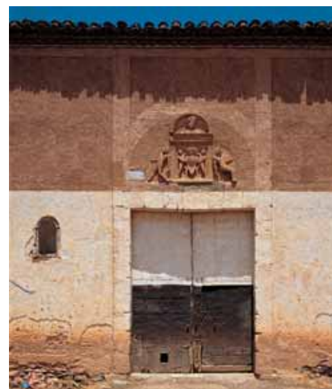
Arriba a la izquierda, interior de las cámaras superiores, con el plano de cubierta resuelto mediante cañizos sobre rollizos. Arriba a la derecha, chimeneón en el interior del conjunto. Abajo, detalle de la portada de acceso principal, con dintel adovelado coronado por un edículo toscano.
