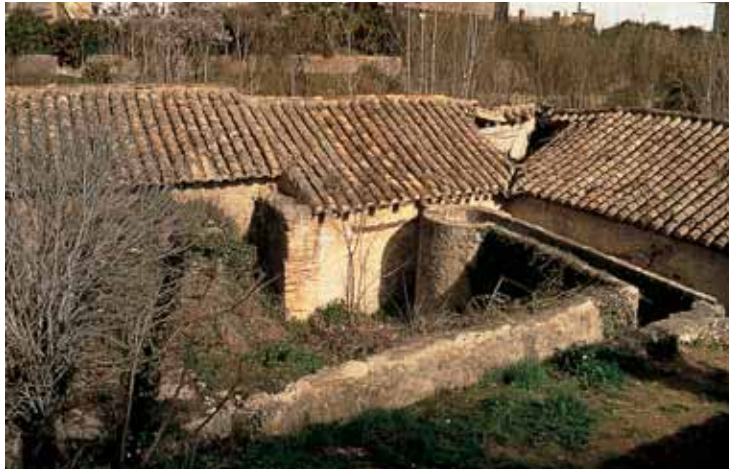
Detalle del caz y el cubo para el salto de agua que accionaba el molino de aceite.
