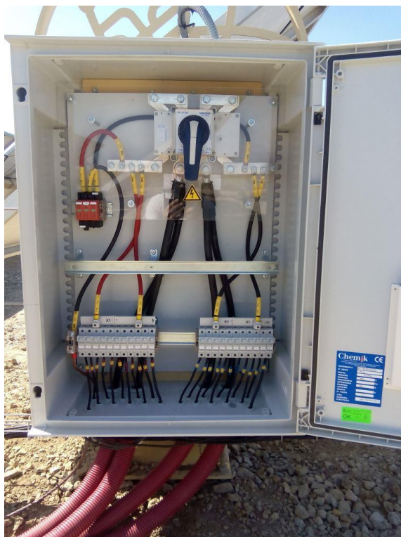
Figura 46: Caja de conexión de 1º nivel con 12 (strings).
