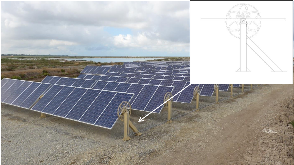
Figura 39: Refuerzos de rigidización.
