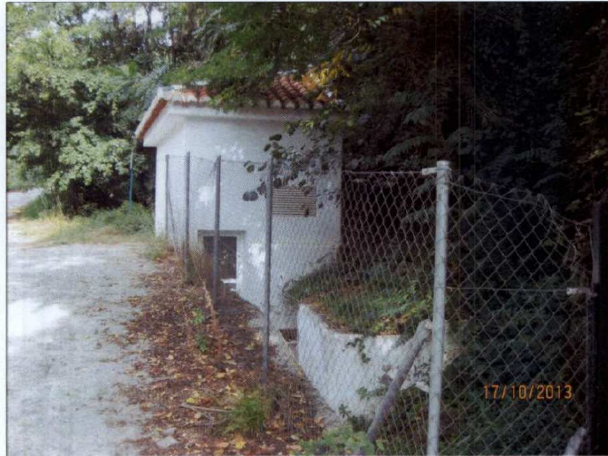
Fotografía nº 4.- Manantial BAÑOS: Caseta de protección e instalaciones.
