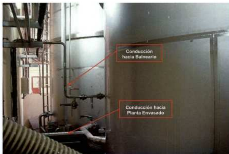
Fotografía 8. Conducciones del manantial San Vicente.
