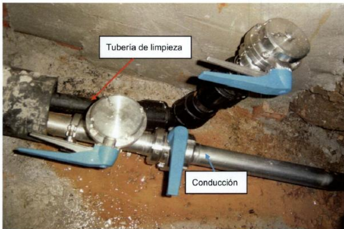
Fotografía 3. Tubería de limpieza.
