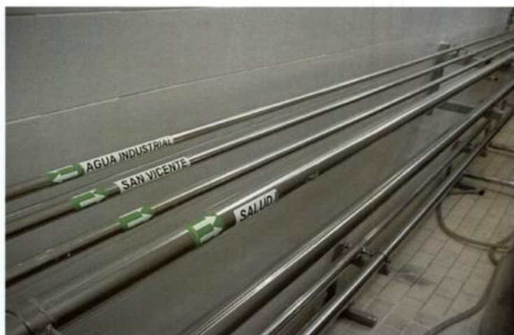
Fotografía 7. Conducciones de acero inoxidable en el interior de edificio.
