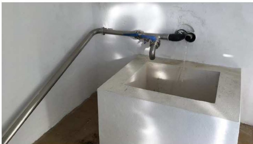
Figura 1.2.- Instalaciones manantial de San Vicente
