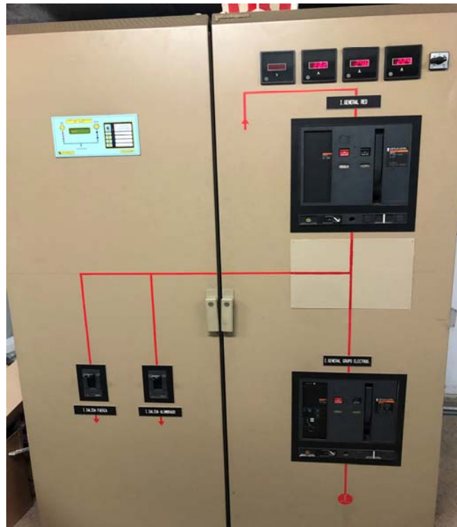
Imagen Cuadro de Conmutación RED - GRUPO existente
