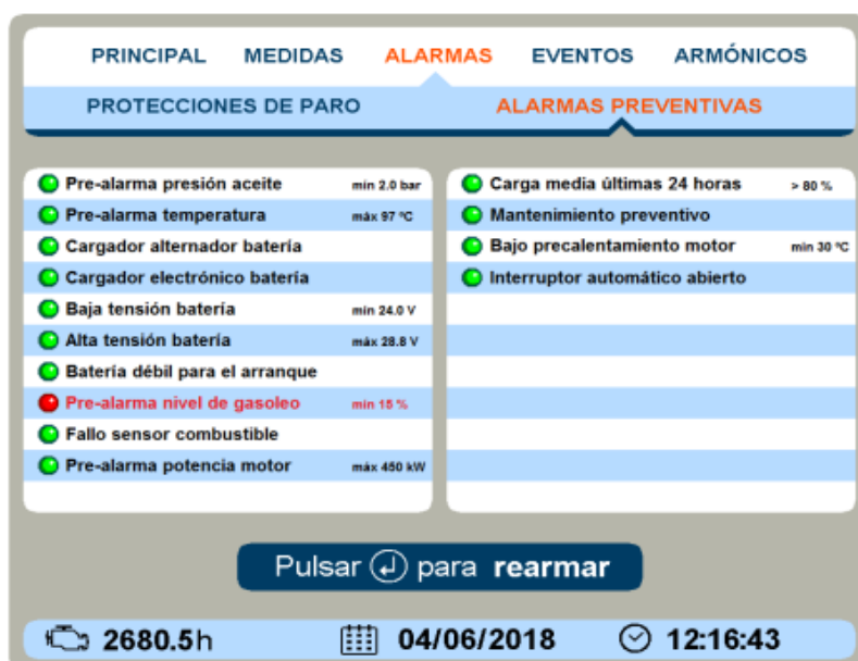
Pantalla de alarmas preventivas del grupo electrógeno
