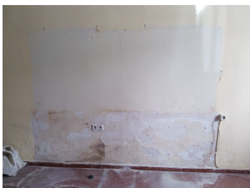
HUMEDADES DE CAPILARIDAD EN LOCALES
