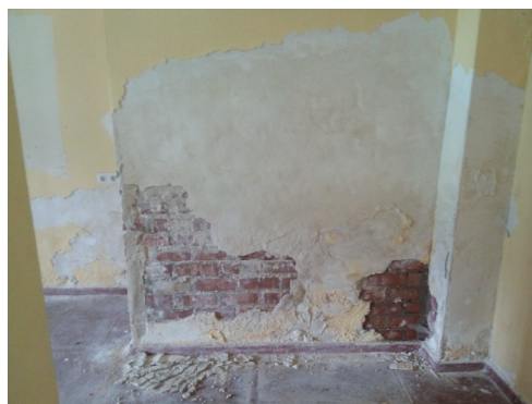
HUMEDADES DE CAPILARIDAD EN LOCALES
