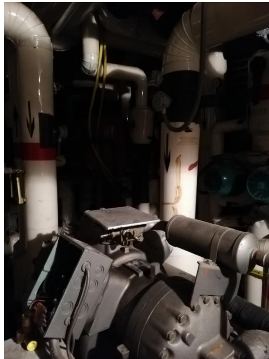
Sala de instalaciones B
