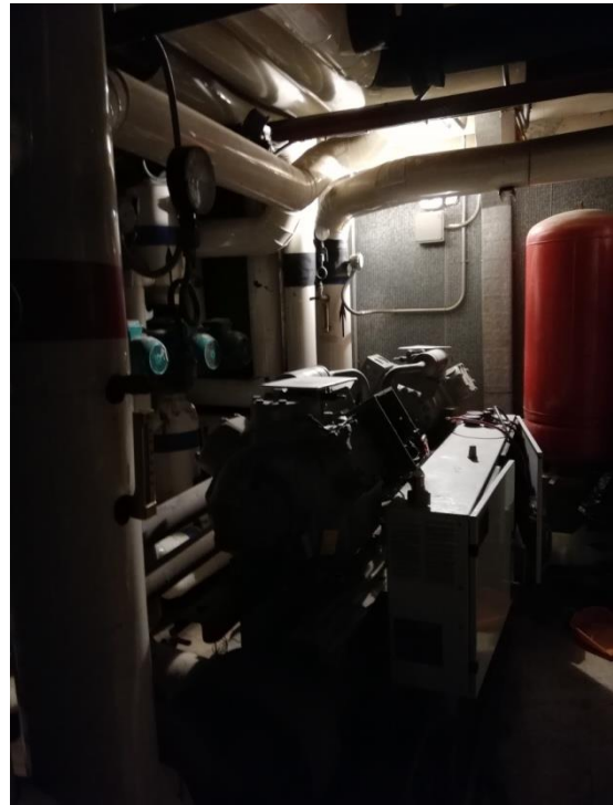
Sala de instalaciones B
