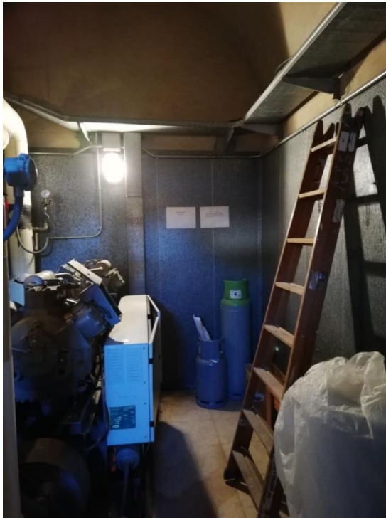
Sala de instalaciones A
