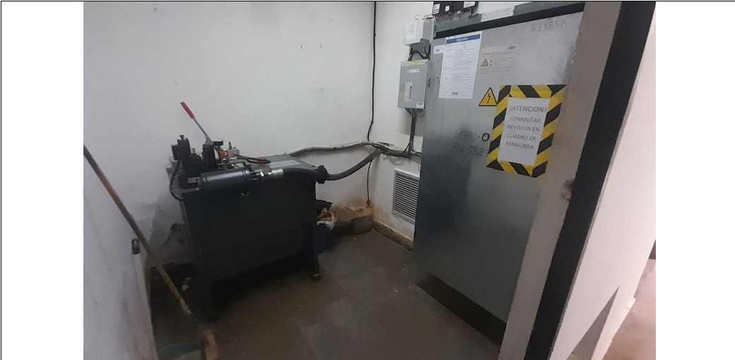
Fotografía N° 7. Sala de máquinas del ascensor
